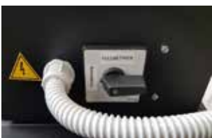
Umschalter Feld- und Einspeisebetrieb
